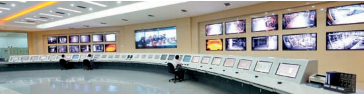
玻纤池窑总控制室
